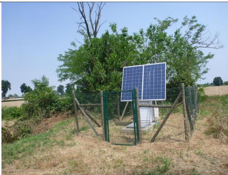
Stazione OL01: potenza dei pannelli fotovoltaici portata a 500W. L'impianto fornisce una tensione di 24V alla strumentazione installata
