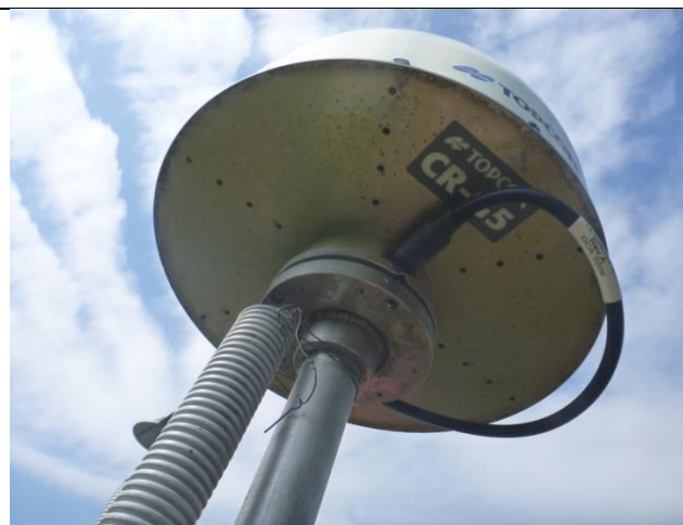
Stazione OL01: controllo, pulizia e nastratura del connettore dell'antenna Choke Ring del ricevitore geodetico GNSS Topcon G5
